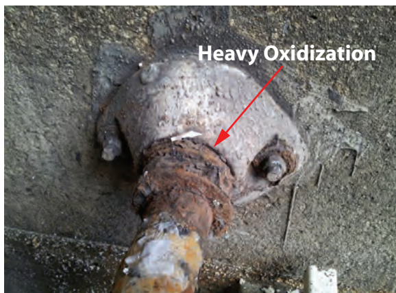
Metalowe łożysko ścienne, skorodowane do tego stopnia, że wał jest zablokowany.
